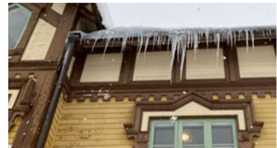
Yläpohjan lämpövuotoihin viittaava jääpadotus räystäällä
