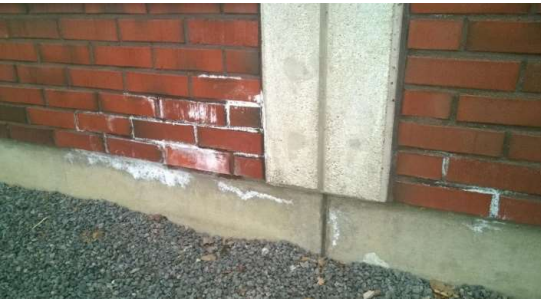
Ulkopuolisen kosteudenhallinnan puutteet
