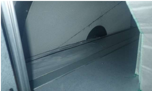
Ilmanvaihtokoneiden pattereiden ja LTO -laitteiden silmämääräinen tarkastus
