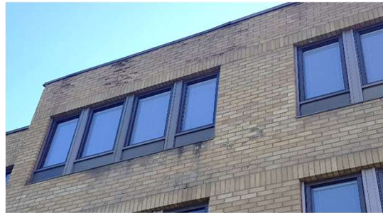
Julkisivujen rapautumisvauriot, ikkunapellitysten kunto
