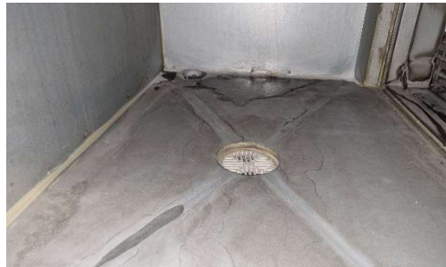
Tuloilmakammion kunto ja viemärointi
