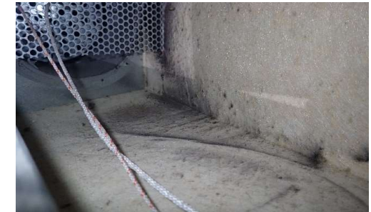
Päätelaitteiden vaimennusmateriaali Voiko päätelaitteiden vaimennusmateriaalista irrota mineraalivillakuituja sisäilmaan?
